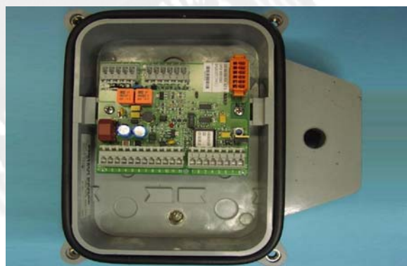
Ein-Schleifen-Detektor im Kabelverteiler
