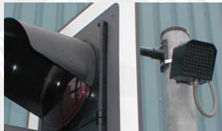
Lautsprecher am Signalmast
