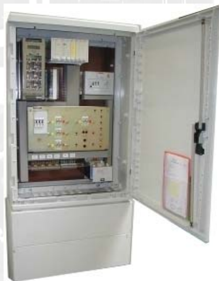
Schaltanlage BUEP-hLz im Schaltschrank
